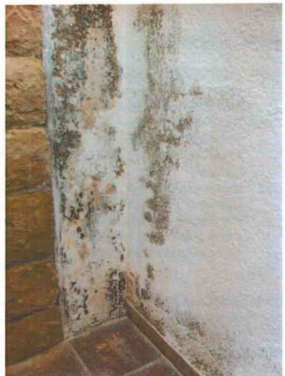
Fissures i humitats en pilars i tabic
