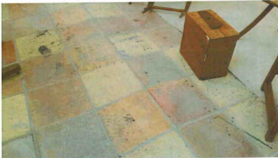
Abombament en paviment interior
