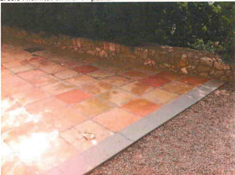
Fissures en paviment exterior.
