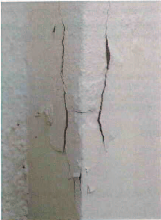
Fissures en pilars
