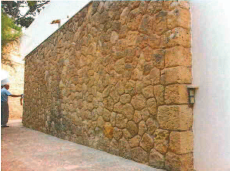
Erosió i humitat en mur de pedra.
