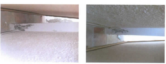
P.15 Fissures base pilar
