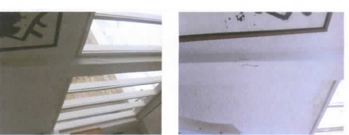
P.19 Fissures pilar
